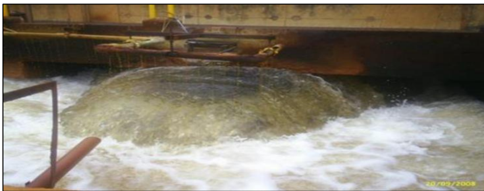
FIGURA 14 – Tanque onde é realizado o processo de cloração.
