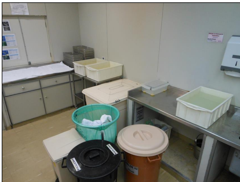
Figura 6 - Imagem da área de recepção do instrumental cirúrgico do CC, antes das adequações realizadas.
