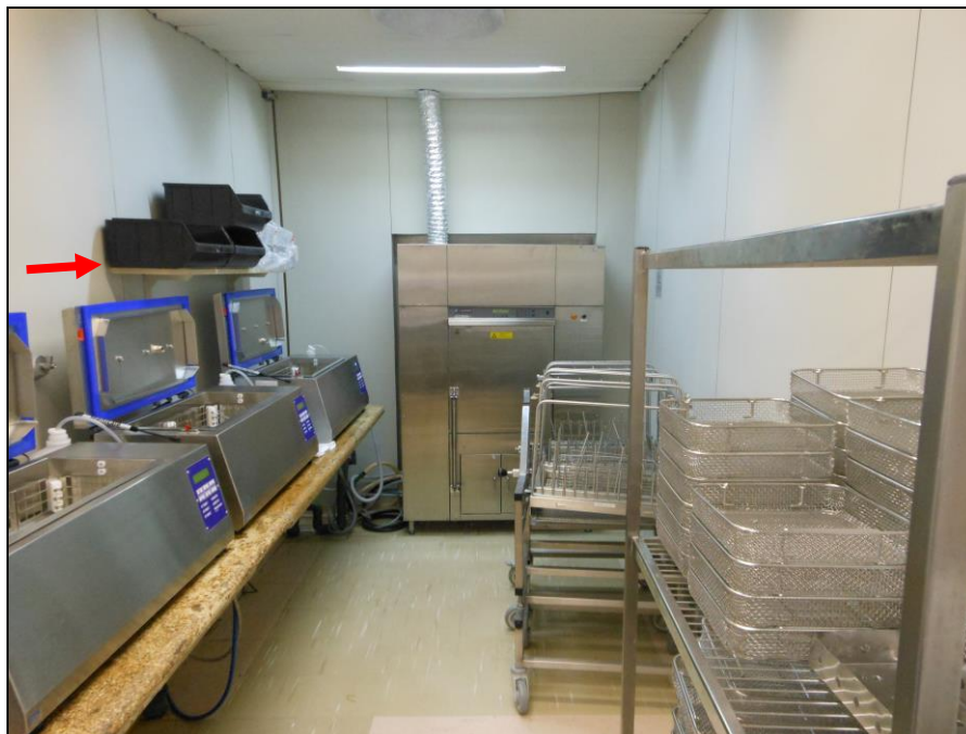
Figura 16 - Prateleira de fórmica para armazenamento de recipientes que acondicionam material limpo em cima da bancada das lavadoras ultrassônicas.
